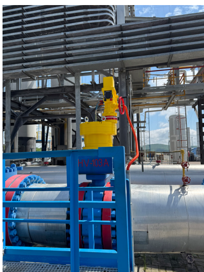
Электропривод РэмТЭК.П.32000.30 (крутящий момент – 32 тыс. Н·м, время перекрытия – 30 с) на поворотном затворе КС «Краснодарская» ООО «Газпром трансгаз Краснодар»
